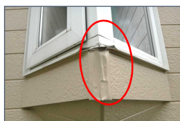
落雪による窓枠の破損
