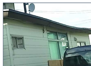
積雪による屋根の歪み
