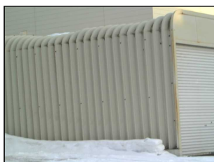
落雪で車庫天井の歪み
