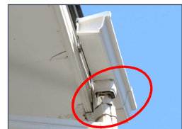
雪害で雨樋の損傷
