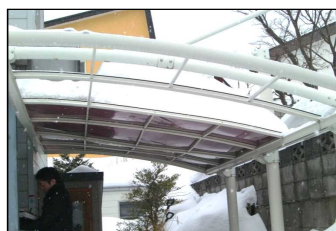
雪の重みでカーポート天井破損
