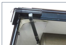
雪庇による軒天損傷
