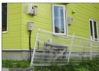
屋根の雪が当たり柵が破損
