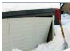
積雪により物置が破損
