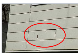
落雪による外壁の破損
