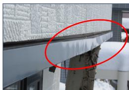
積雪により支持金具が緩み 雪解け水が浸入し腐食
